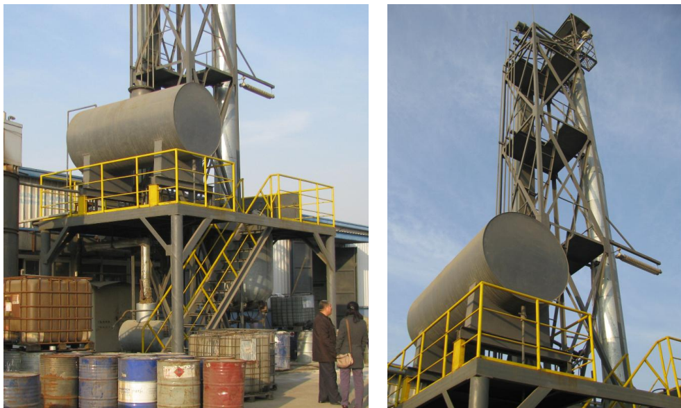
(c) 废有机溶剂的蒸馏处理单元及不凝气排口
